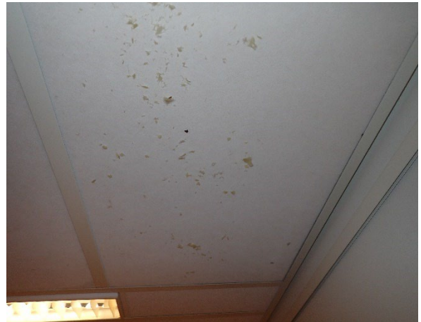
Kuva 38. Akustiikkalevyissä havaittiin rikkiäisiä pintoja.
