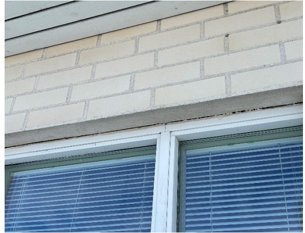
Kuva 32. Ikkunoiden ja ulkoseinien liittymät ovat epätiivit.
