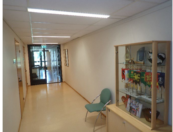
Kuva 57. Käytävillä on metallisia palo-ovia.
