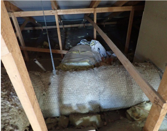
Kuva 35. Yläpohjatilassa havaittiin jonkin verran rakennusjätteitä.
