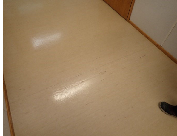
Kuva 12. Muovimatto on halki liikuntasauman kohdalta.
