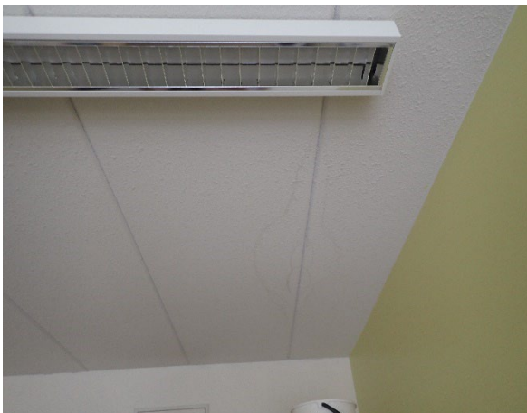
Kuva 43. Huoneiden puolella kevytbetoni-lankut ovat roiskerapattuja. Katossa havaittiin joitakin vanhoja kosteusvaurioiden aiheuttamia vaurioita.
