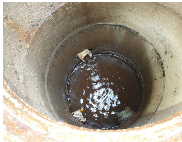
Kuva 4. Tarkastuskaivojen pohjalla on vettä, salaojaputkien alapinnan alapuolella.
