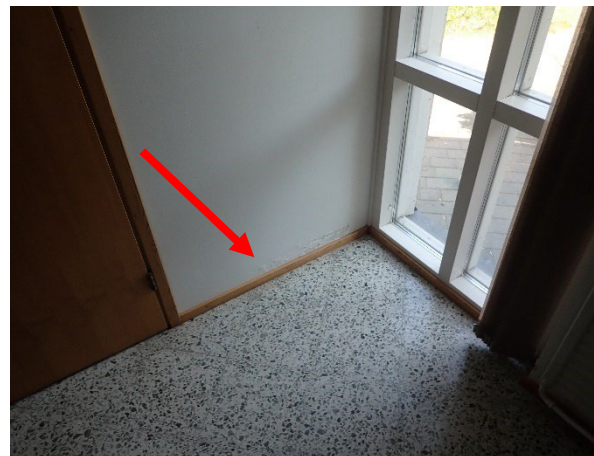
Kuva 55. Aulan wc:n vastaisella seinällä havaittiin vaurioita väliseinän tasoitepinnassa.
