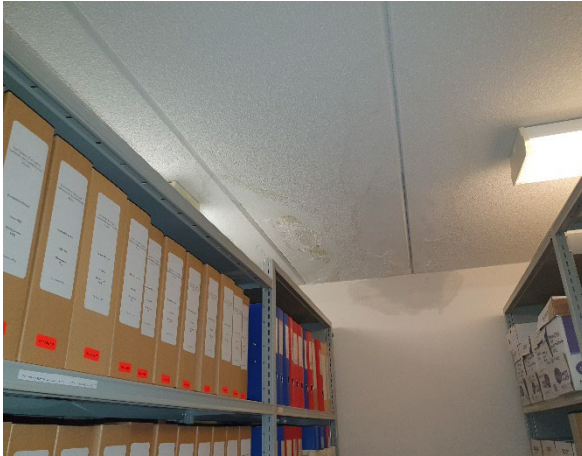
Kuva 59. Katossa havaittiin kaksi erillistä vaurioitunutta kohtaa.
