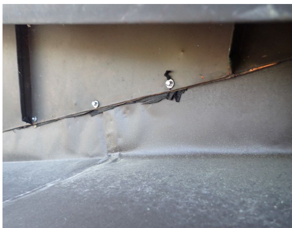
Kuva 47. Kuparikaton ja uuden peltikatteen välissä havaittiin solumuovinauha.
