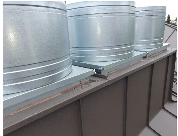
Kuva 62. Vesikatolla vastaavassa kohdassa sijaitsee poistoilmapuhaltimia.
