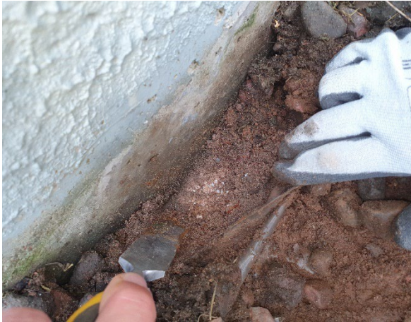
Kuva 22. Sorastuksen alla havaittiin rakennusmuovi ja routasuojan lämmöneriste.
