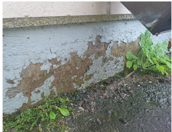
Kuva 21. Kattosadevedet rasittavat sokkeleita.
