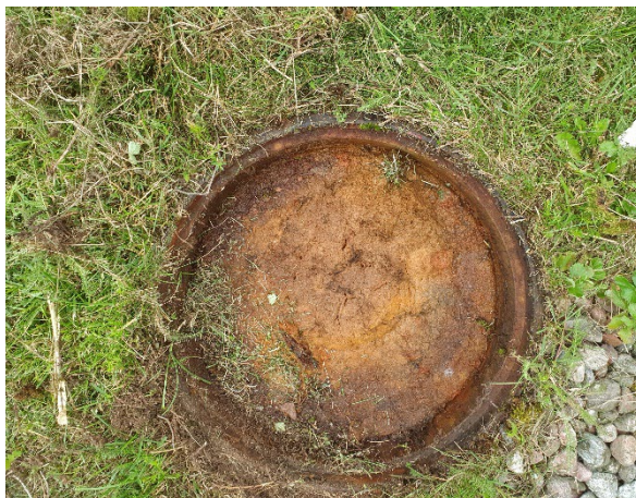
Kuva 3. Tarkastusluukun alla olevan välikannen päällä oli runsaasti vettä ja epäpuhtauksia.
