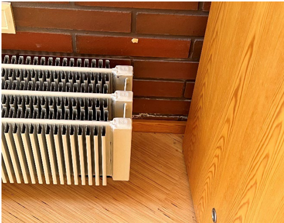
Kuva 24. Valtuustosalin seinän alaosassa havaittiin kalkkihärmettä.
