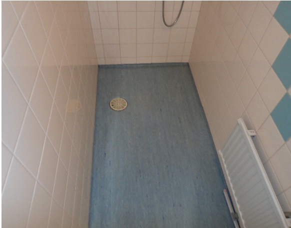
Kuva 11. Miesten suihkutiloista mitattiin kohonneita lukemia pintakosteuskartoituksessa.
