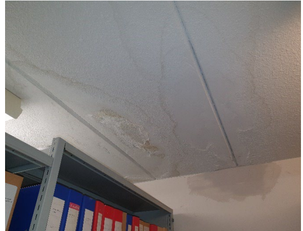
Kuva 60. Vasemmanpuoleinen kohta on nyt havaittu, uusi, vaurioitunut kohta.
