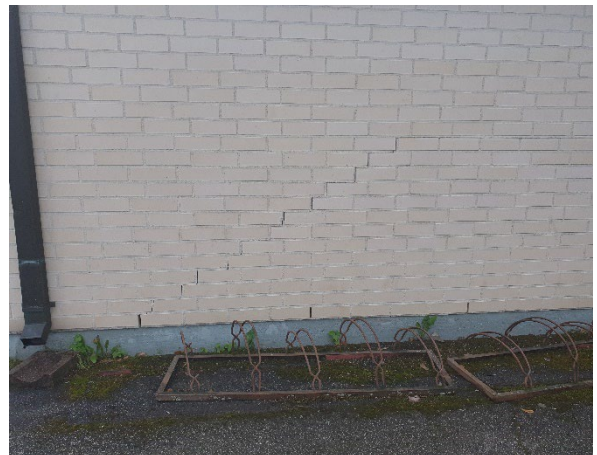
Kuva 17. Julkisivun tiilimuurauksen saumalaasteissa on jonkin verran halkeamia.
