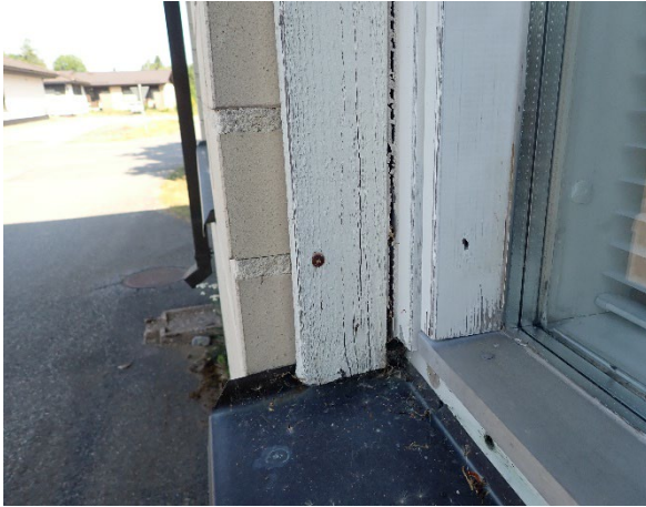
Kuva 31. Puuikkunoiden maalipinta on heikko ja ikkunan liittymät ovat epätiivit.
