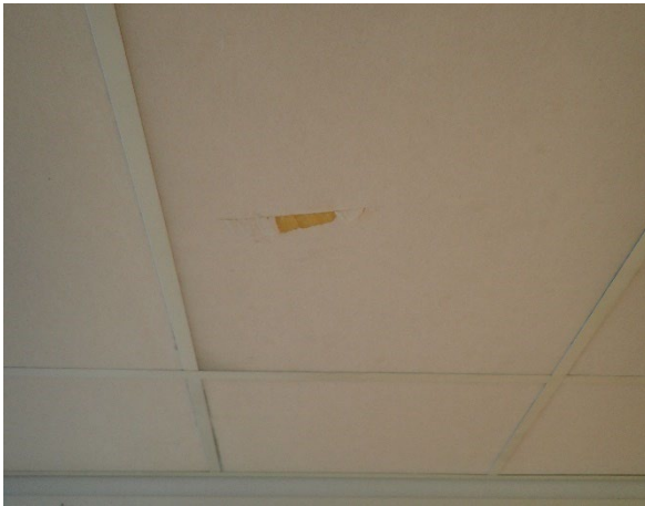
Kuva 37. Akustiikkalevyissä havaittiin rikkiäisiä pintoja.
