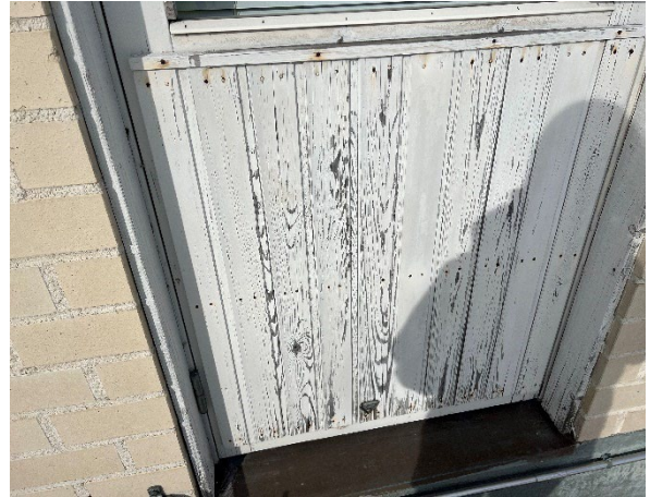
Kuva 26. Puiset ulko-ovet ovat alkuperäisiä ja niiden maalipinta oli paikoin huonokuntoinen.
