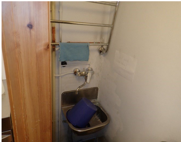
Kuva 52. Seinän toisella puolella olevassa siivouskokerossa on havaittu vesivahinko, joka on jo korjattu.
