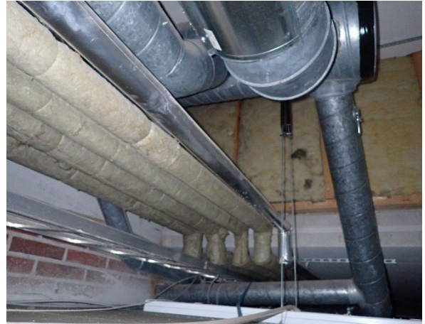
Kuva 40. Alakaton yläpuolisessa tilassa on runsaasti pinnoittamatonta mineraalivillaa.
