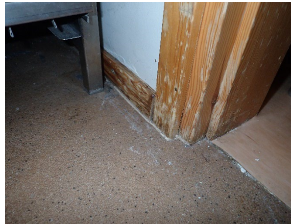
Kuva 53. Siivouskomeron ja keittiön välisessä levyrakenteisessa seinässä ja puulistoissa havaittiin kosteuden aiheuttamia vaurioita.
