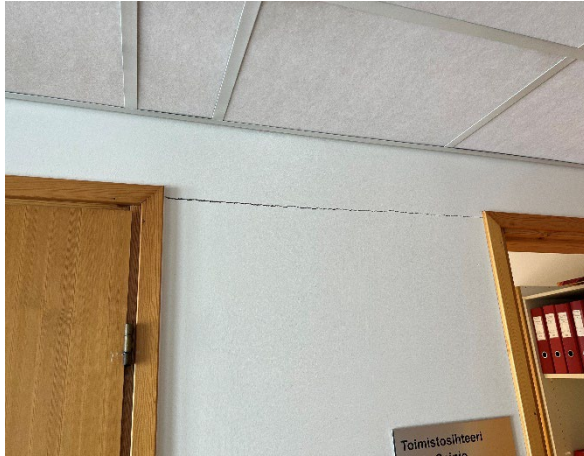
Kuva 50. Käytävien väliseinissä havaittiin halkeamia.
