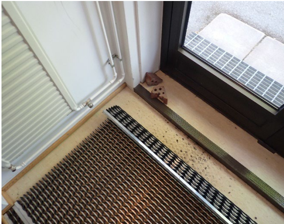
Kuva 9. Luoteen puoleisen ulko-oven edestä mitattiin kohonneita lukemia.
