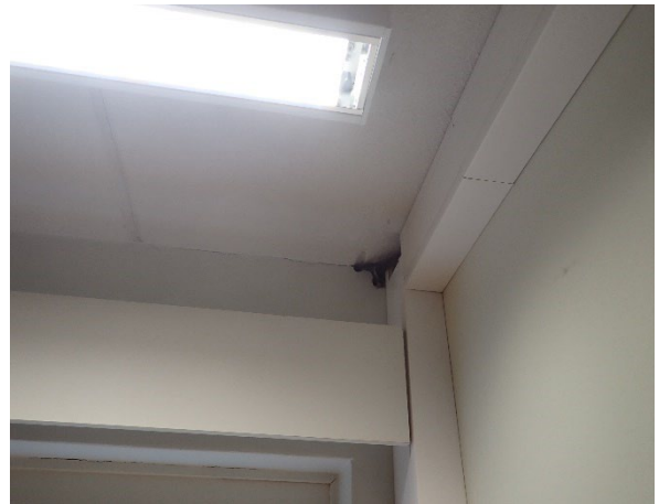
Kuva 42. Yläpohjan ja ulkoseinien liittymissä havaittiin ilmavuotoja ja epätiiveyskohtia.
