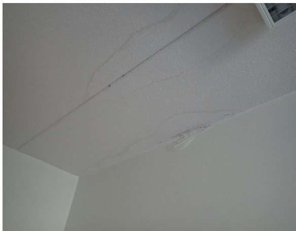
Kuva 54. Projektikoordinaattorin huoneen katossa ja seinän yläosassa havaittiin kosteuden aiheuttamia vaurioita sekä kohonnutta kosteutta pintakosteuskartoituksessa.
