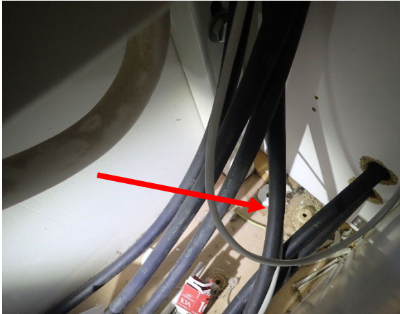
Kuva 7. Sähkökaapin pohjalla on runsaasti epäpuhtauksia ja kuivuneita kosteusjälkiä.
