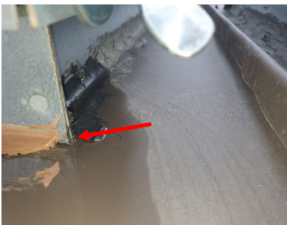
Kuva 63. Puhaltimien ja pellitysten liitoksissa havaittiin useita epätiivittä liitoksia.
