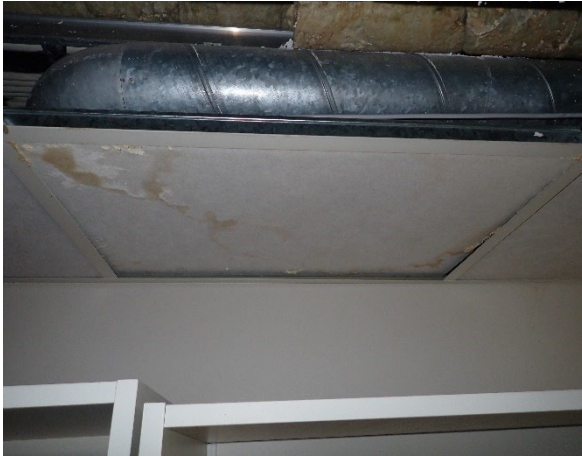
Kuva 39. Akustiikkalevyissä havaittiin joitakin kosteuden aiheuttamia vaurioita.
