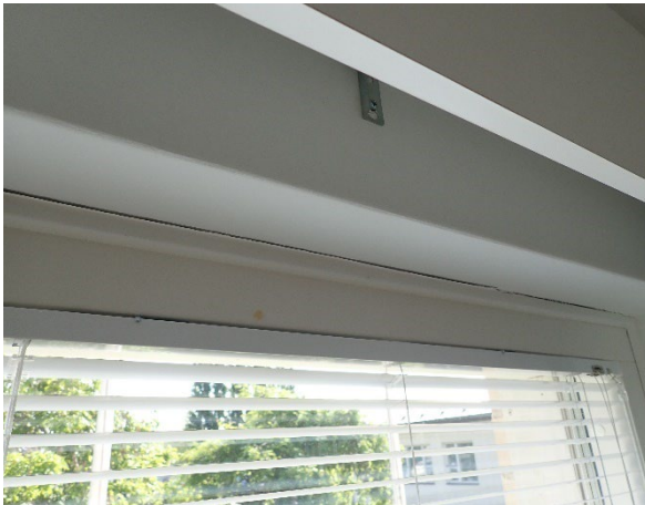
Kuva 33. Ikkunoiden liittymät ulkoseiniin ovat epätiivit.
