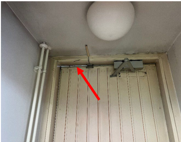
Kuva 27. Puuovissa havaittiin merkittävää epätiiveyttä.
