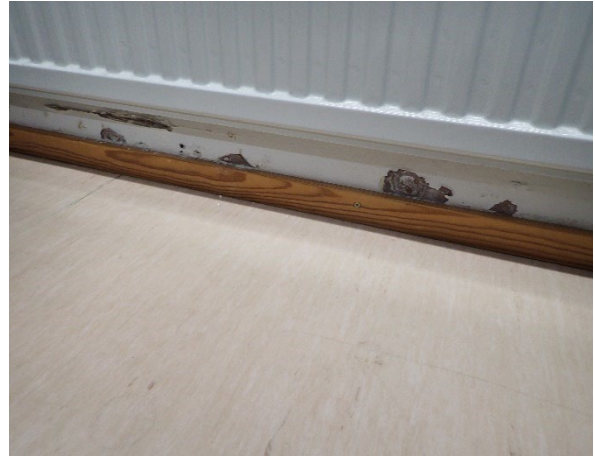
Kuva 23. Seinän alaosassa havaittiin maalipinnan hilseilyä.
