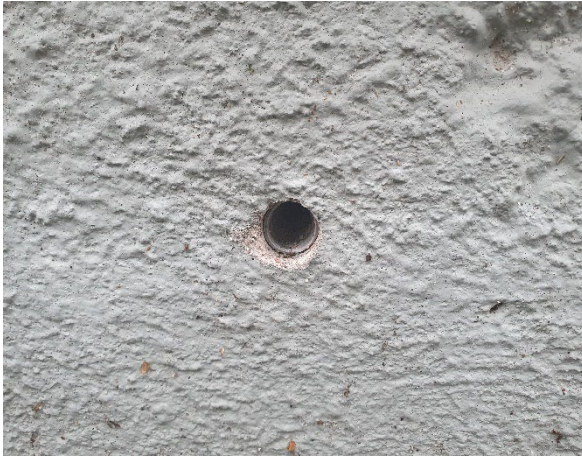
Kuva 18. Sokkelissa havaittiin pieniä tuuletusputkia.
