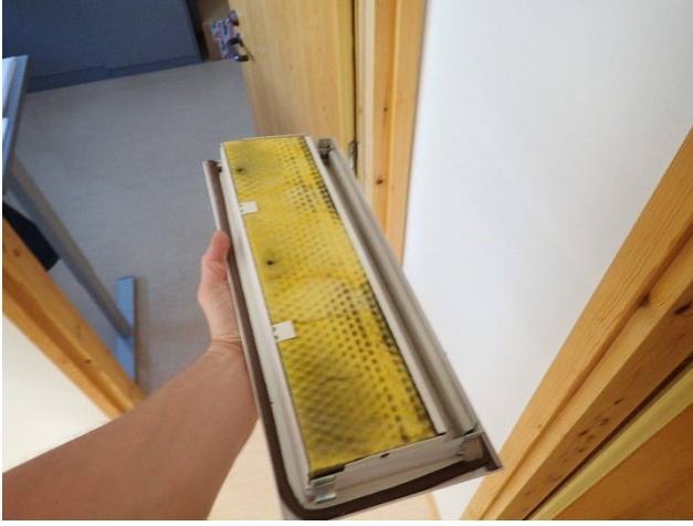
Kuva 11. Jakolaatikoissa oli näkyvää äänieristevillaa havaittavissa, joka toimii kuitulähteenä.
