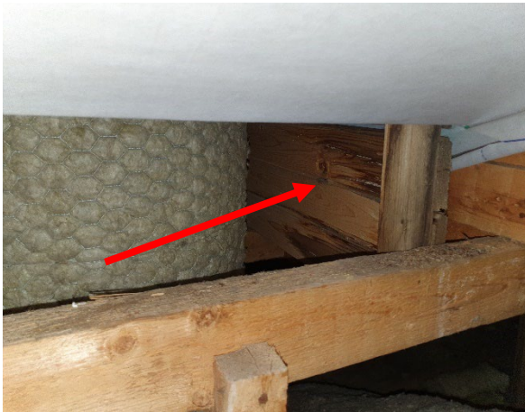
Kuva 61. Yläpohjan puisissa kattotuoleissa havaittiin kosteuden aiheuttamaa tummentumaa vauriokohdan yläpuolella.
