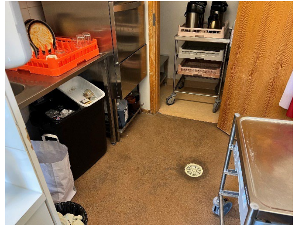
Kuva 10. Tiloissa on alkuperäiset lattiamateriaalit. Keittiön viereisen siivouskomeron lattiasta mitattiin kohonneita lukemia pintakosteuskartoituksessa.
