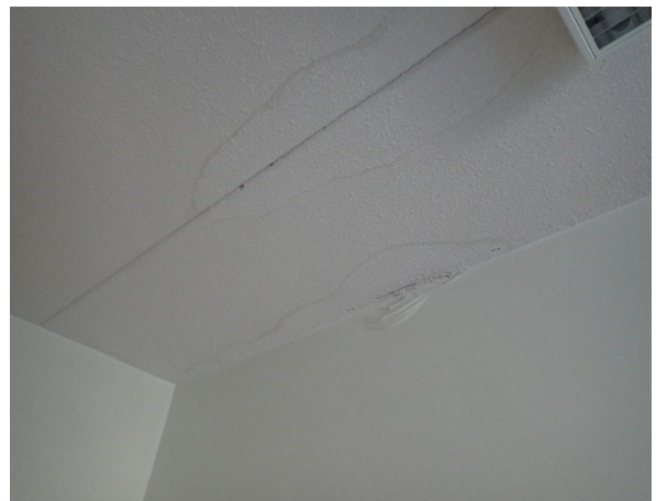
Kuva 44. Huoneiden kevytbetoni-lankuissa havaittiin joitakin vanhoja kosteusvaurioita.
