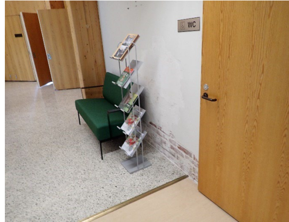
Kuva 51. Aulan ja siivouskomeron välisen seinän alaosa on puhdistettu tiilipinnalle siivouskomeron vesivahingon vuoksi.
