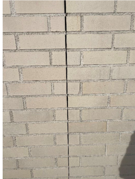
Kuva 19. Liikuntasaumojen kohdassa ei ole elastista saumausta.
