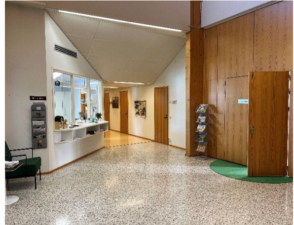
Kuva 8. Aulan laatoituksesta havaittiin kopoja kohtia ja jonkin verran kohonneita lukemia pintakosteuskartoituksessa.
