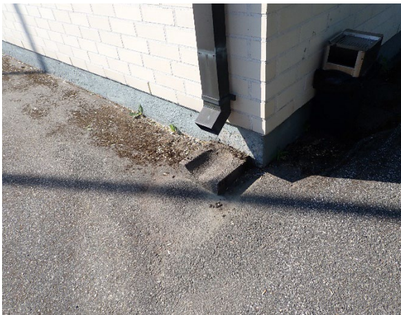
Kuva 20. Kattosadevedet rasittavat sokkeleita.
