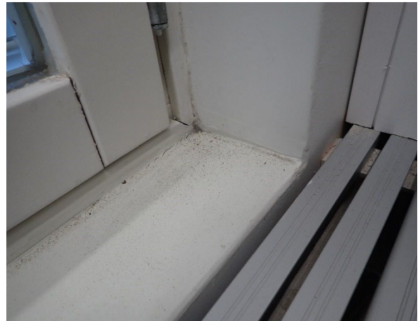
Kuva 34. Ikkunapenkeillä oli epätiivien liitosten kautta tapahtuvien ilmavuotojen mukana tuomia epäpuhtauksia.
