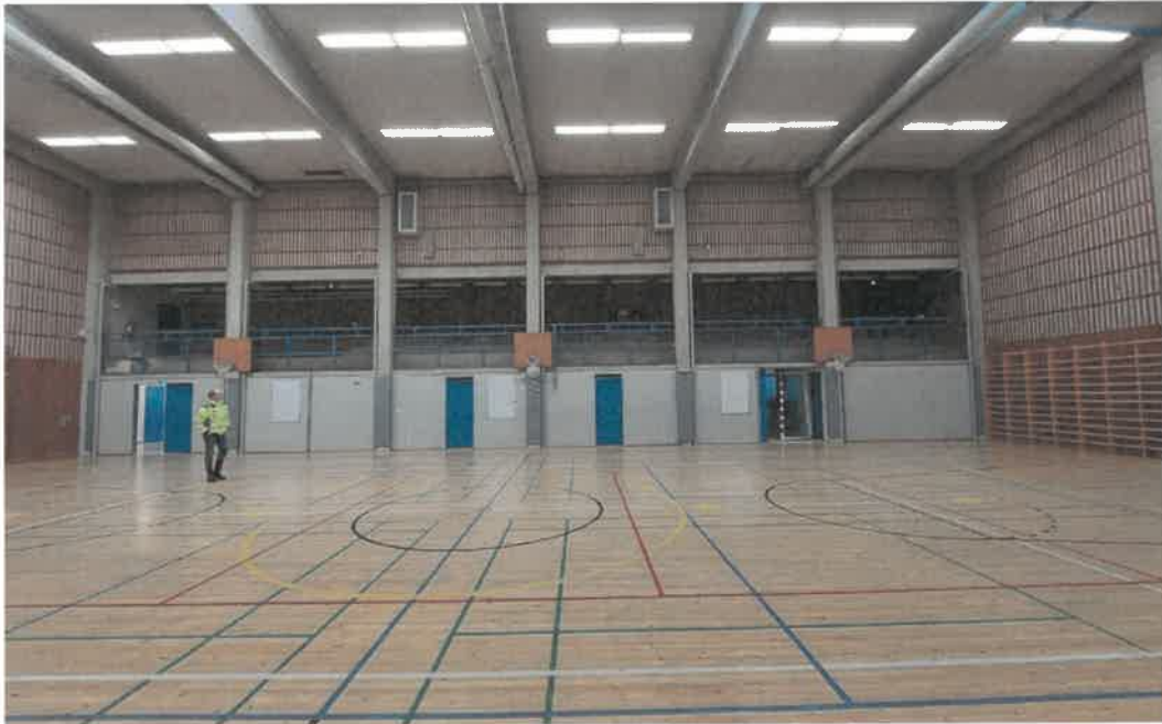
Kuva 1: Näkymä hallista, katsomosivu. Alaosan seinässä ei levytystä, yläosan akustolevytyks vaihdetaan, päällä oleva rimoitus myös. Lattian suojaus esim. vanerointi+ laakerointipahvi alle tms.
