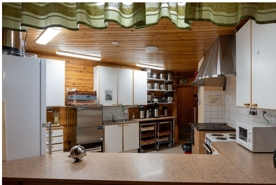
Hiihtomaja, saneerauksen tarpeessa oleva keittiö
